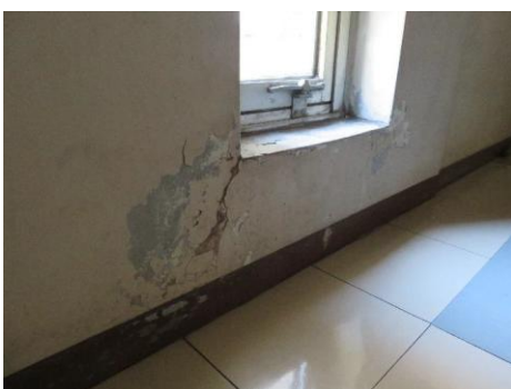
老朽化した庁舎のひび割れ
